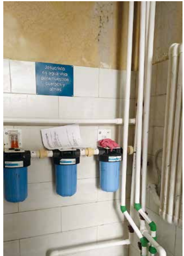
l'impianto di depurazione dell'acqua
